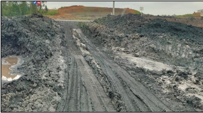
Gambar 3 Kondisi jalan keluar masuk Front Kerja
