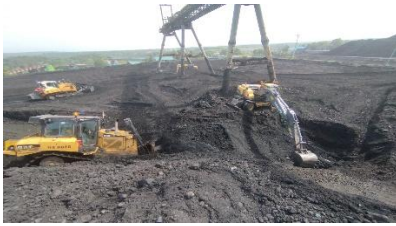
Gambar 17 Area Kerja Tidak Rata Sumber: Dokumentasi Pribadi
