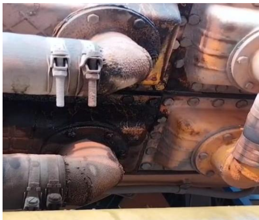
Gambar 2 Indikasi Kebocoran Radiator BELAZ-75135 RT025
